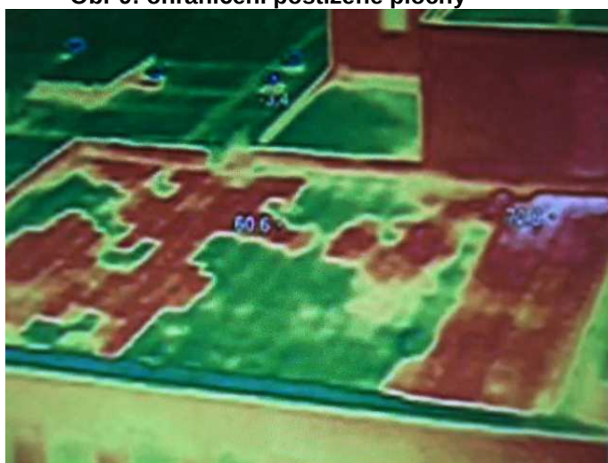
Obr 10: termografický snímek z okolních střešních plášťů
