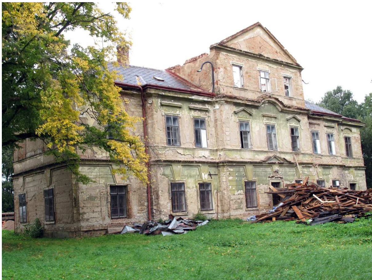
Zámek Barchov – vlhkostní poruchy zdiva souvisejí s dlouhodobě zanedbanou údržbou
