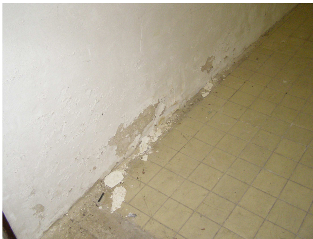
Obr.4 Příklad degradace vnitřní povrchové úpravy způsobené difuzně nepropustným vnitřním nátěrem, výrazně snižujícím kapacitu odparu zvýšené vlhkosti z konstrukce
