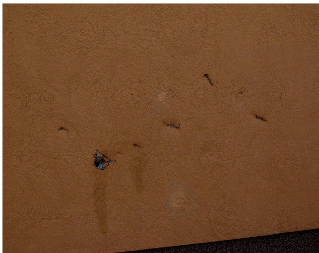
Obr.5 Příklad poškození povrchu zateplené fasády vandalismem
