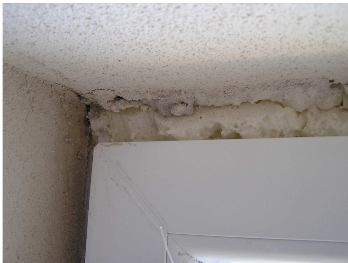
Obr.6 Do této spáry měla být z interiérové strany řešena difúzní parozábrana. Chybí, ale bylo to levné.
