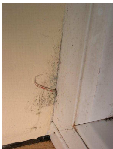
Obr. 1 Výskyt kondenzace s následným růstem plísní – bohužel častý jev při chybné sanaci a výměně oken
