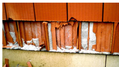
Foto č. 2 – Poškozené zdivo
