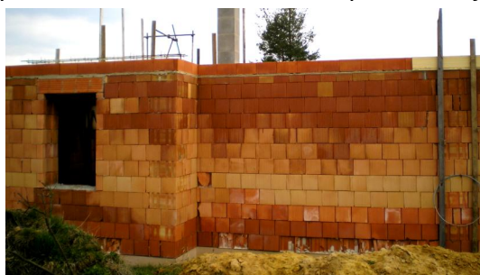
Foto č. 1 – Vlhké zdivo po odtátí sněhu
